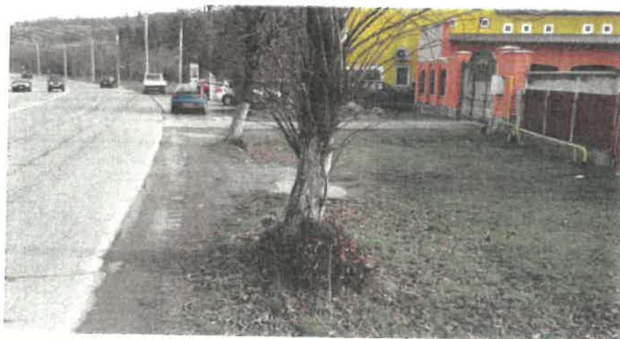
Foto 15. Sector fără trotuar pe partea dreaptă
