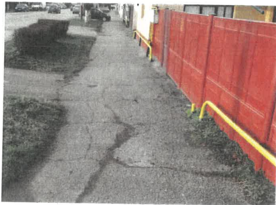
Foto 17. Trotuar stânga degradat (îmbrăcămintă cu crăpături, îmbătrânită)
