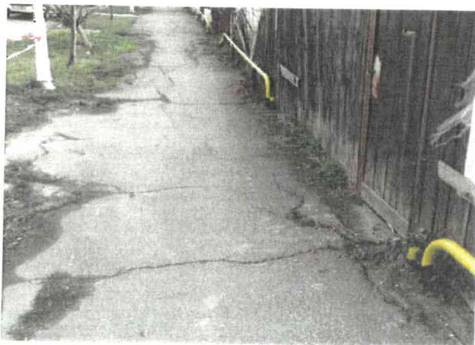
Foto 5. Trotuar dreapta cu fisuri și crăpături multiple. Acces neamenajat
