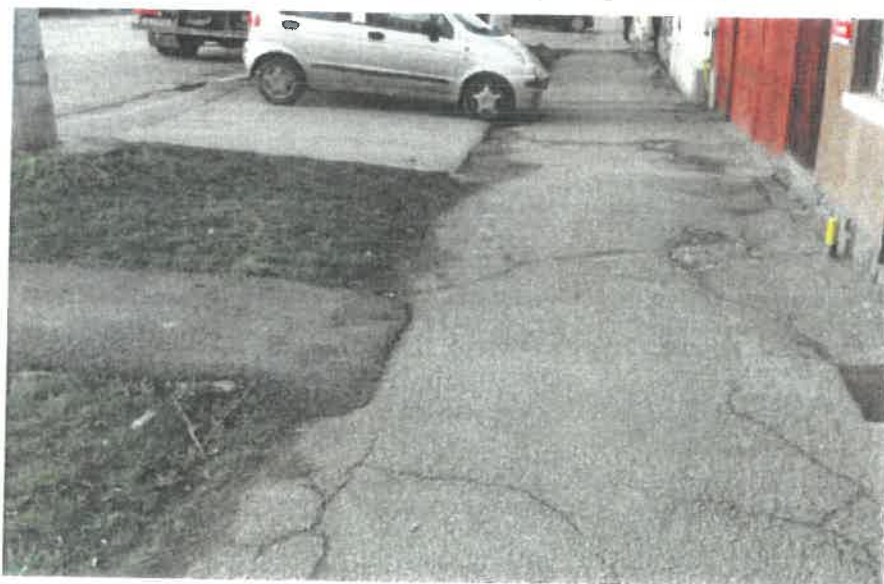
Foto 20. Trotuar stânga. Acces improvizat. Îmbrăcămintă asfaltică fisurată, îmbătrânită
