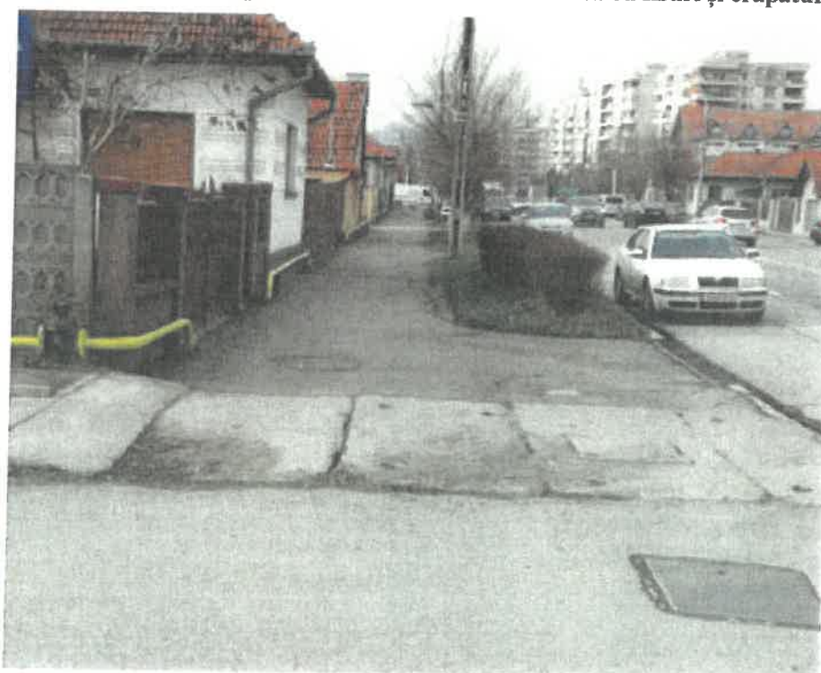
Foto 2. Trotuar dreapta cu îmbrăcămintă de mai multe tipuri, degradată, denivelată. Zonă neamenajată corespunzător
