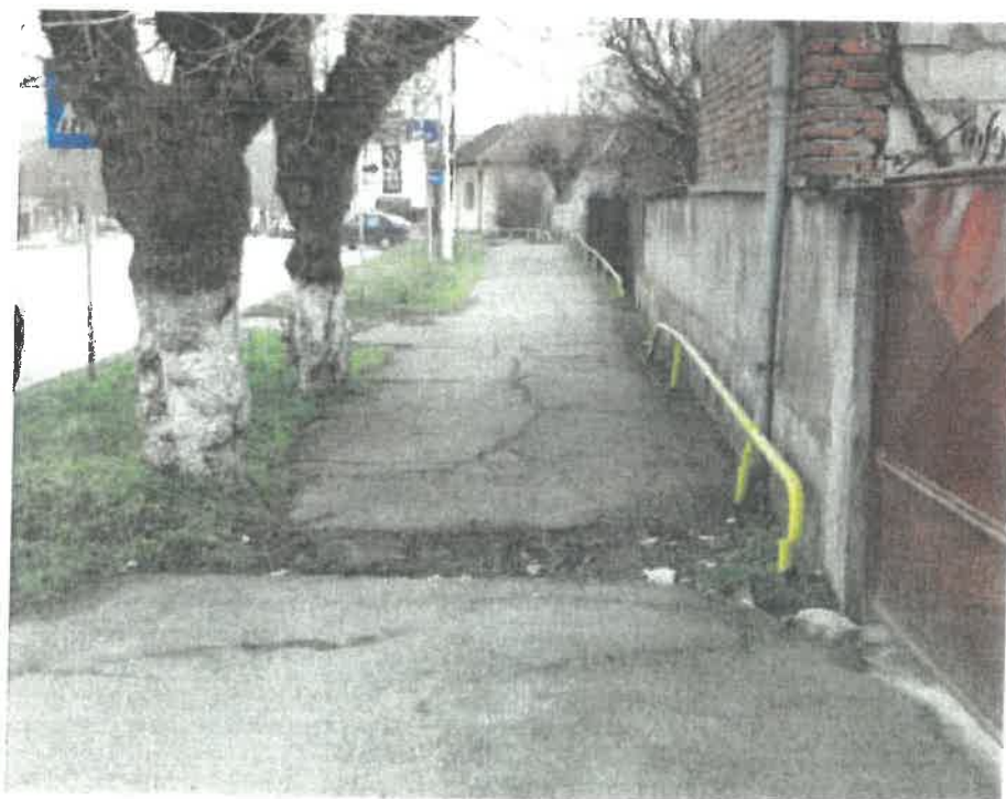
Foto 8. Degradare totală la trotuar dreapta
