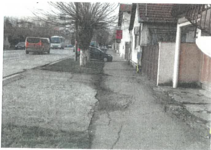
Foto 18. Degradare totală trotuar stânga. Parcare adiacentă improvizată
