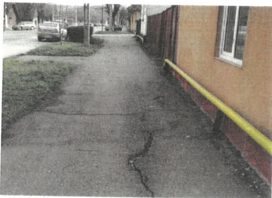
Foto 1. Trotuar dreapta cu îmbrăcămintă bituminoasă cu fisuri și crăpături
