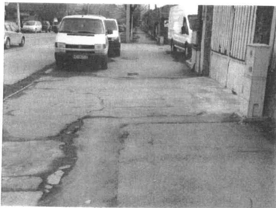
Foto 3. Trotuar dreapta total degradat
