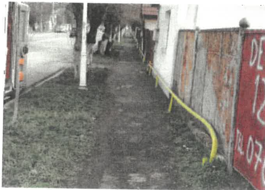
Foto 11. Trotuar dreapta îngust, degradat total
