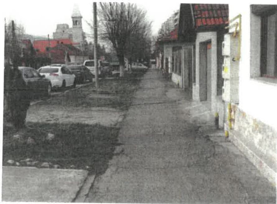
Foto 19. Trotuar stânga cu scurgere ape deficitară
