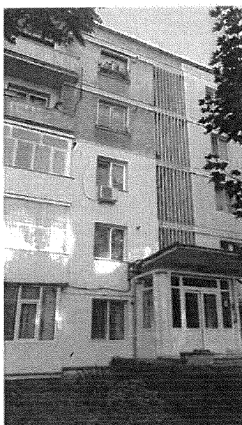
Izolatii partiale neconforme
