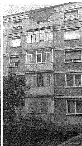
Inchideri balcoane fatada posterioara – neconforme
