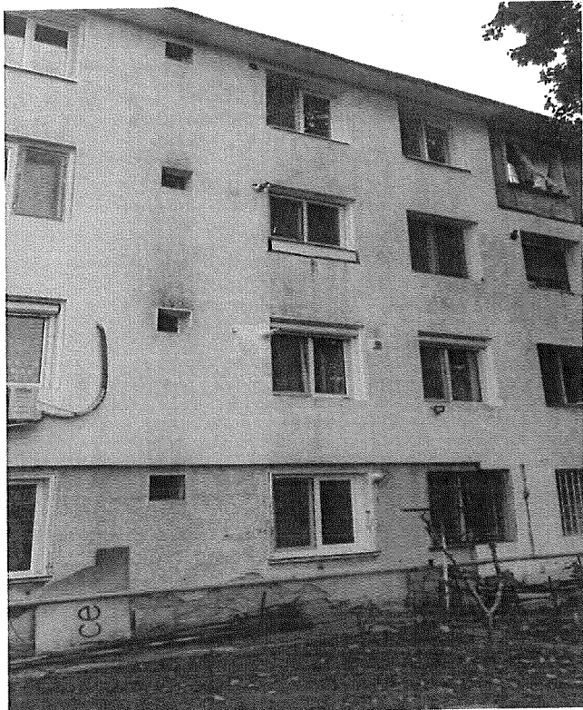
Tencuieli degradate la nivelul soclului
