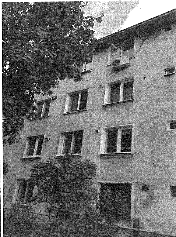
Tencuieli degradate soclului + perete + cornisa
