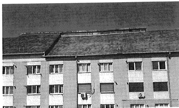
Acoperis – luminatoare sparte
